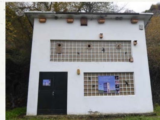
Caseta de transformador eléctrico en desuso con diferentes tipos de nidos y refugios para aves y murciélagos.
